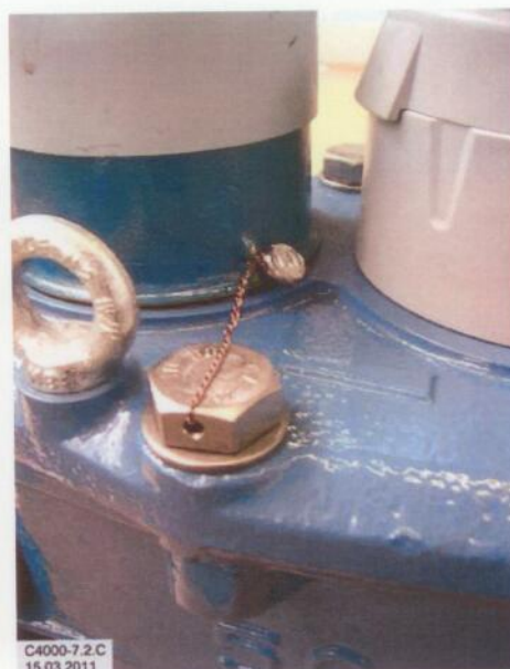
C4000, Plombierung mit Draht, Detail: Sicherung des kleinen Zählers
