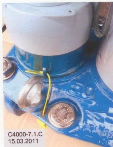
C4000, Plombierung mit Kunststoffplombe, Detail: Sicherung des kleinen Zählers
