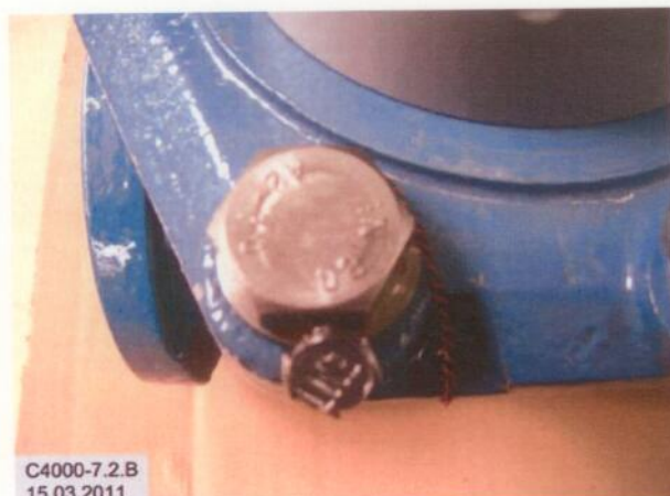
C4000, Plombierung mit Draht, Detail: Sicherung der Deckelschraube
